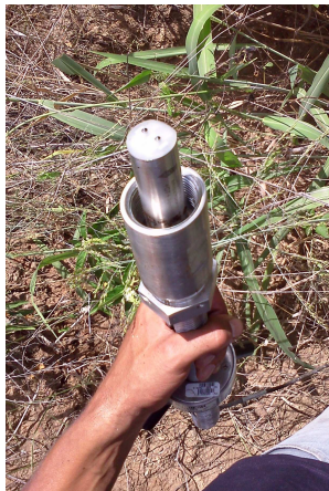
Fig. 6 - Imagem do transdutor do macromedidor de inserção com deposição de materiais.
