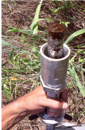
Fig. 5 - Imagem do transdutor do macromedidor de inserção com deposição de materiais.
