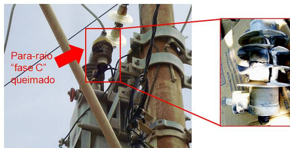
Fig. 4: Caracterização de um para-raio avariado (fora de operação).
